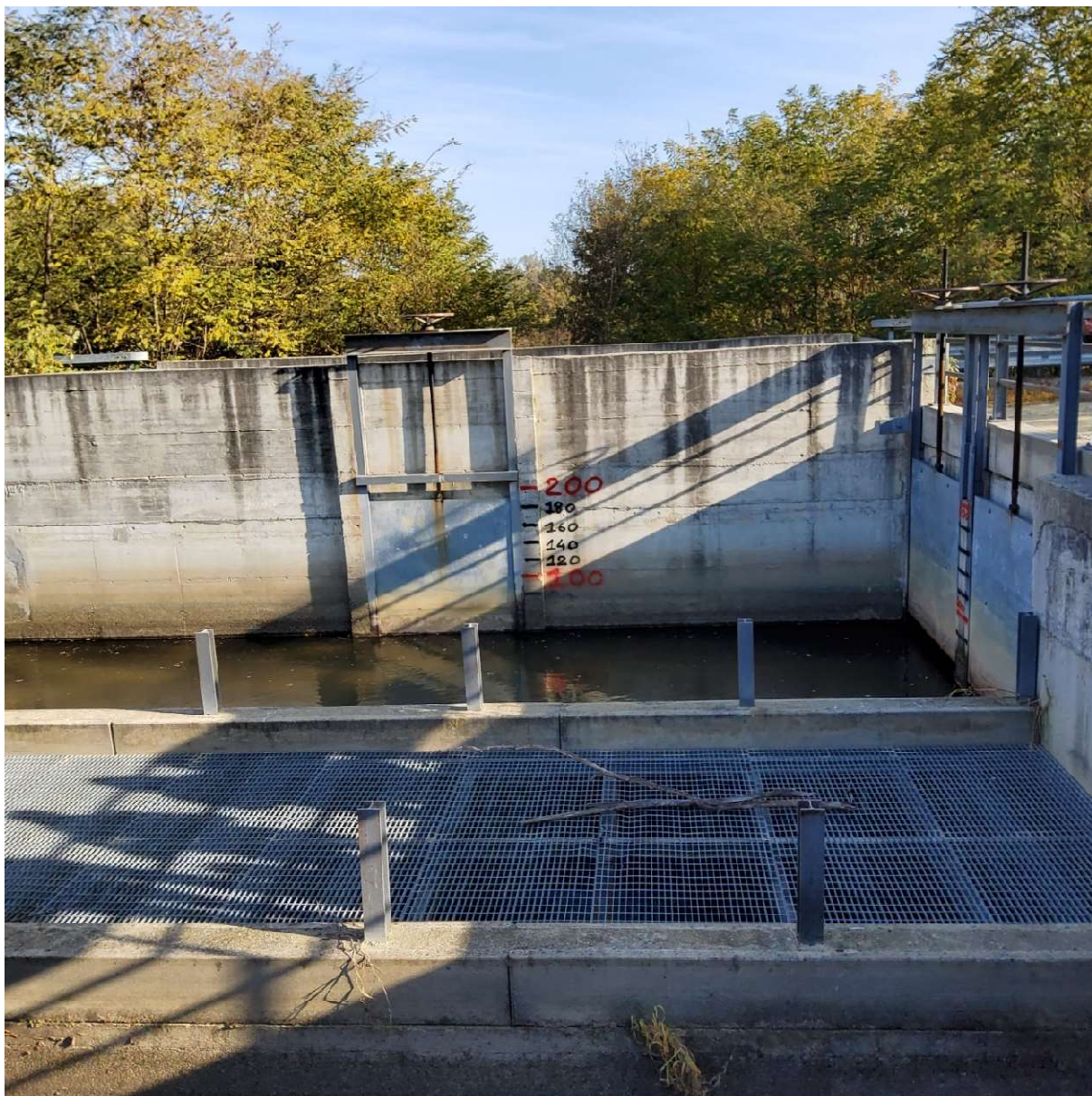
Organi di manovra dello Scolmatore 2° Lotto (roggia Reiola)
